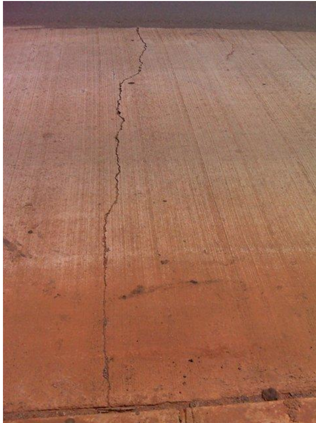
Placa quebrada (trinca transversal)
