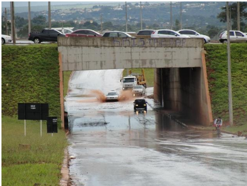
Inexistência de drenagem pluvial na Trincheira da EPVL.
