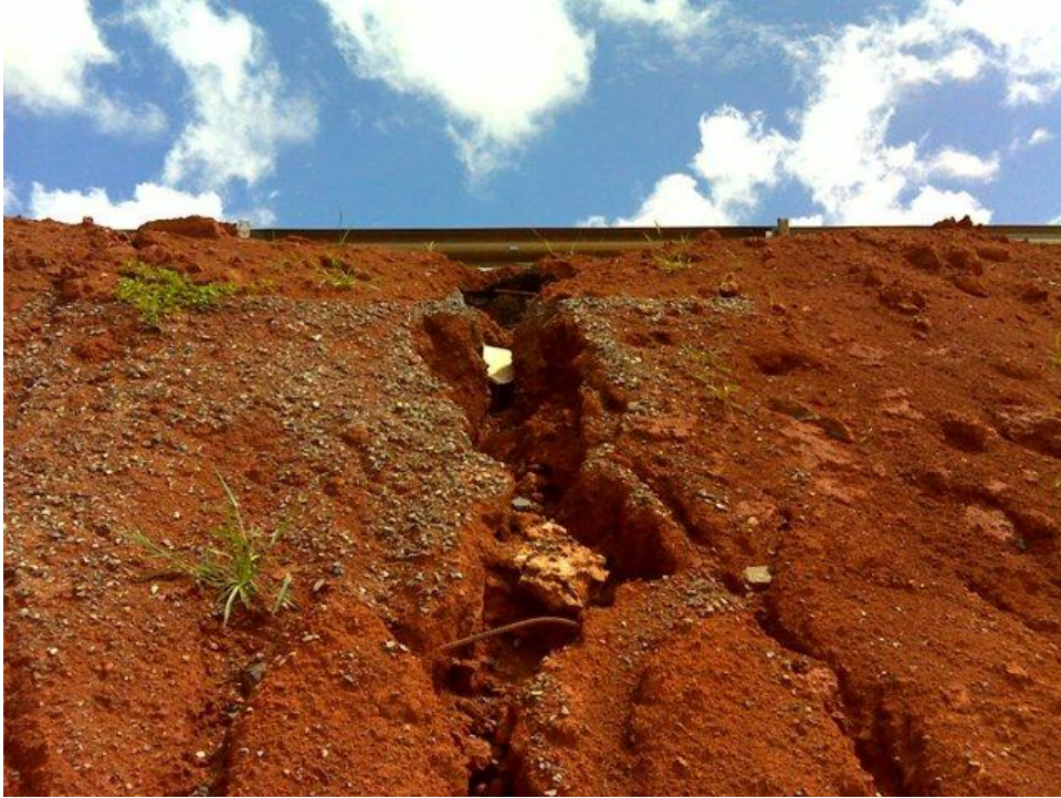
Comprometimento de talude por erosão.
