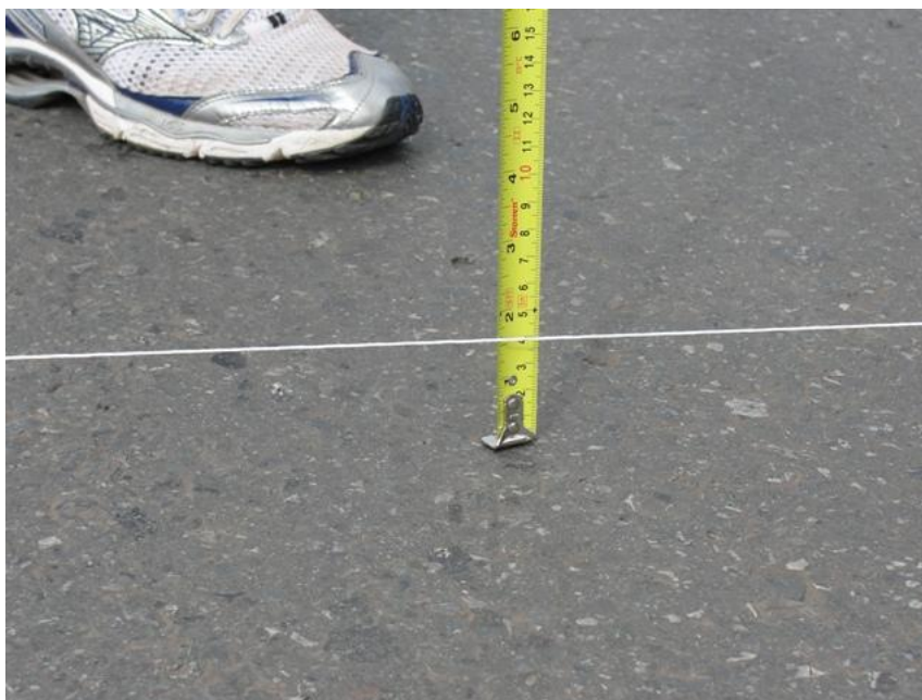
Detalhe do erro de concordância (quatro cm de afundamento).
