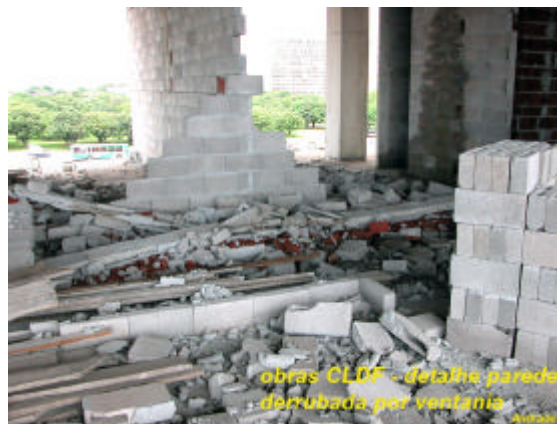
Foto 4 – Paredes do prédio administrativo derrubadas pelo vento.
