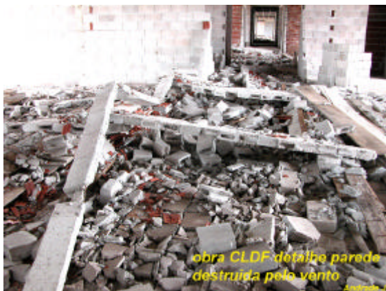
Foto 3 – Paredes do prédio administrativo derrubadas pelo vento.
