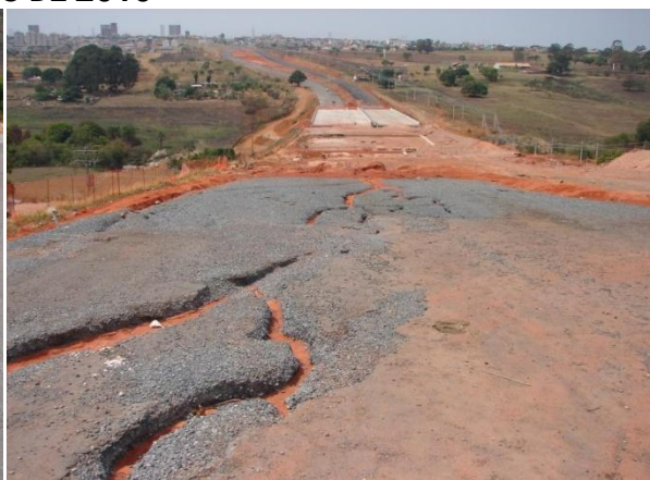
Foto 2 – Trinca Pista Esquerda
