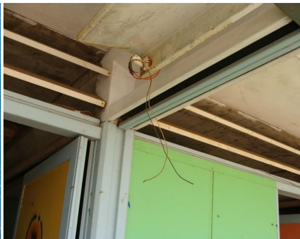
Foto 4 – Fiação Exposta na Sala de Aula
