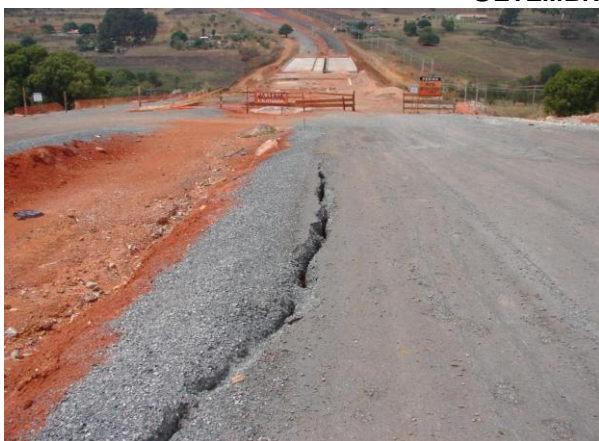
Foto 1 – Trinca Pista Direita
