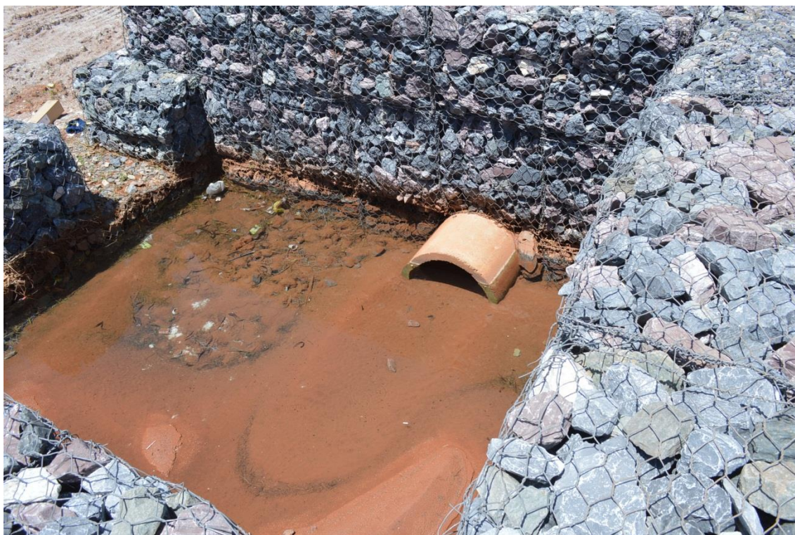
Diminuição da seção transversal útil da tubulação de drenagem devido ao acúmulo de terra.
