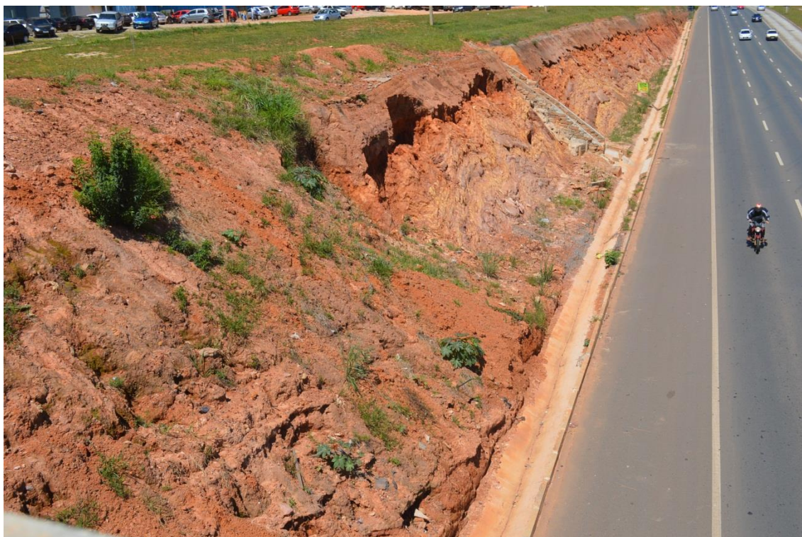
Talude com ausência de cobertura vegetal e apresentando erosão.
