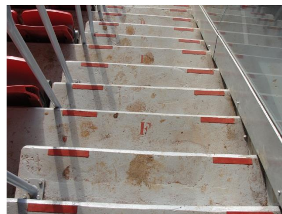
Detalhe da precária sinalização horizontal
