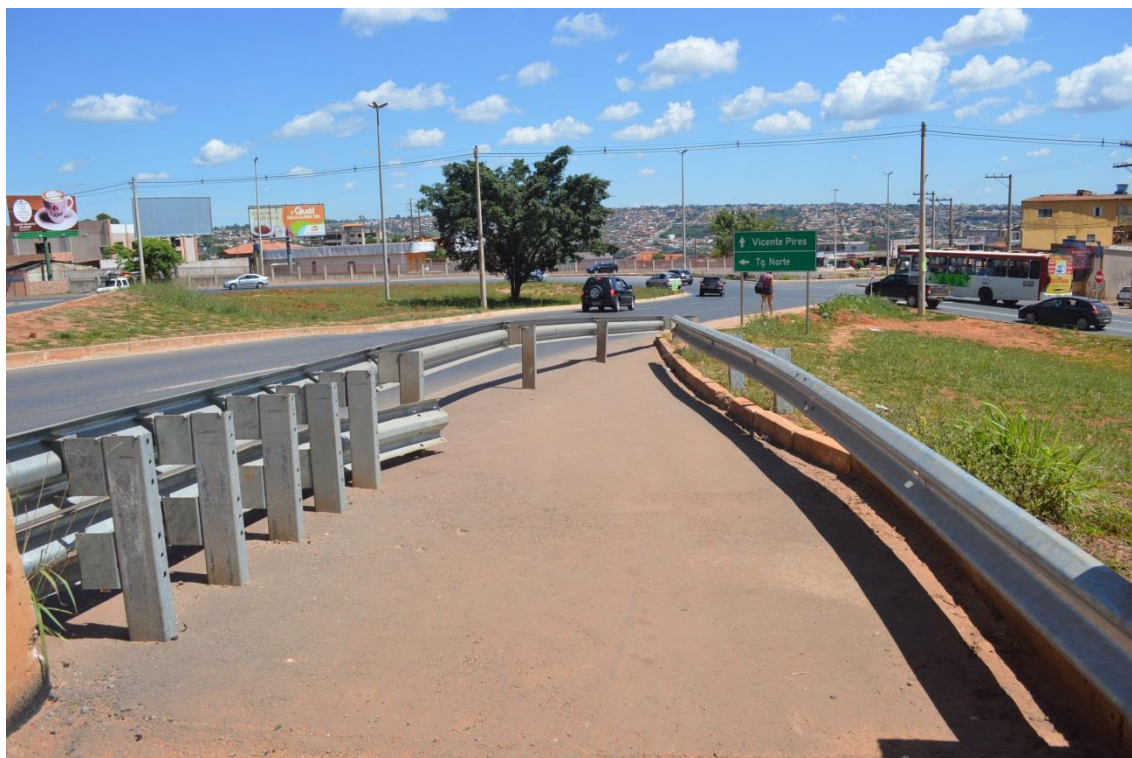
Lâmina solta e execução de defensas em local onde não transitam veículos.
