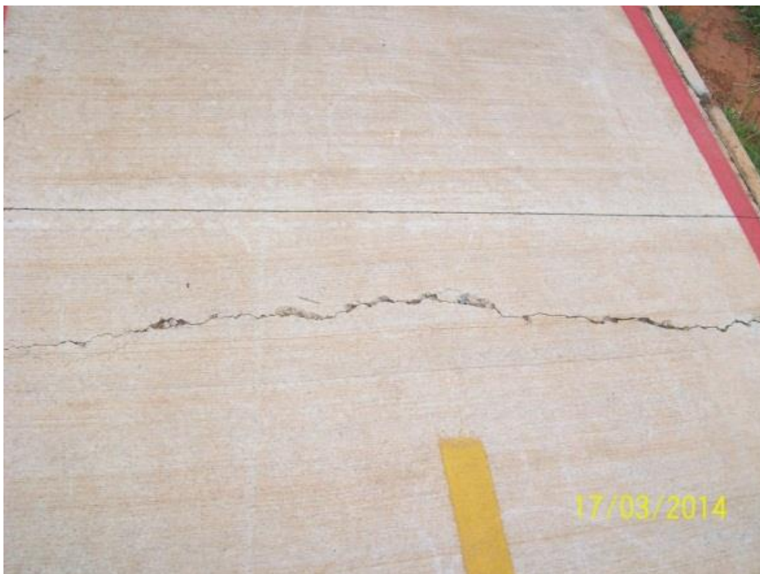
Trinca por fissuração do concreto – Lote 7 (UnB)
