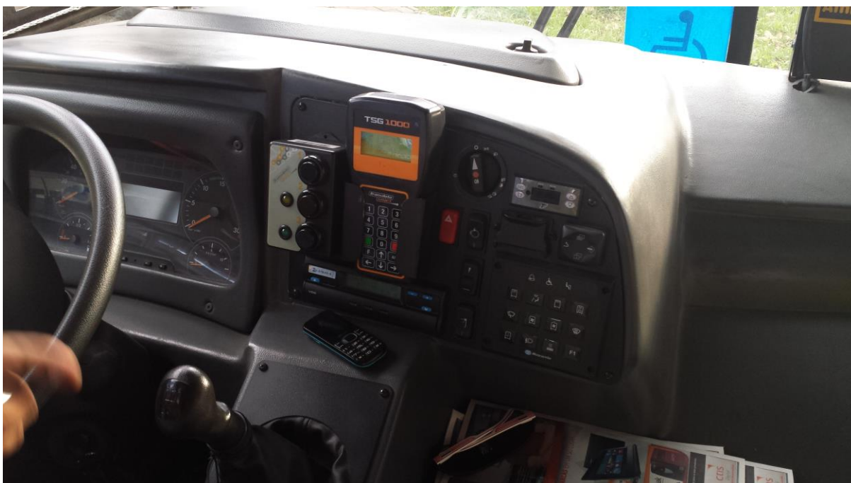
Módulo de apoio à operação instalado em ônibus da Viação Piracicabana.
