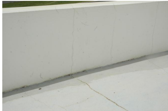
Rachadura na Rampa Lateral Sul do Museu.
