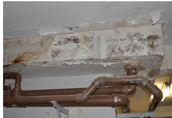
Infiltração da piscina na área interna do complexo.
