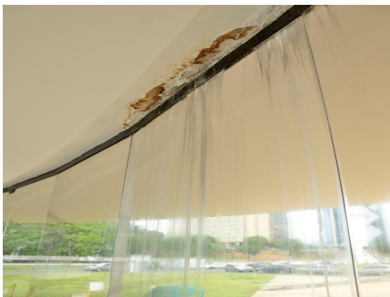
Infiltração nas esquadrias do anexo do Museu.
