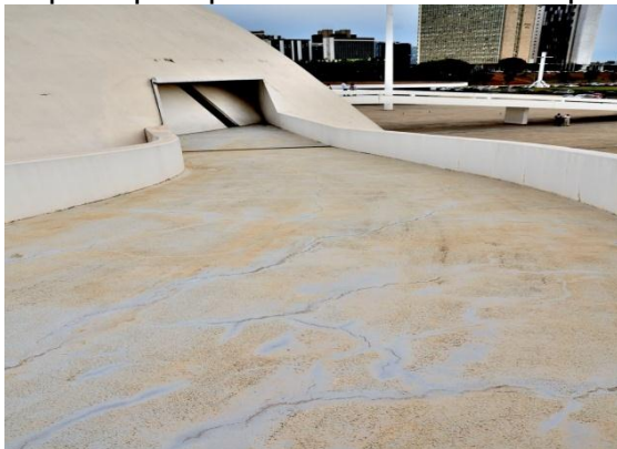
Rachaduras na rampa de acesso do Museu da República.
