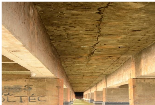
Trinca na parte inferior do tabuleiro da Ponte das Garças apresentando sinais de infiltração.
