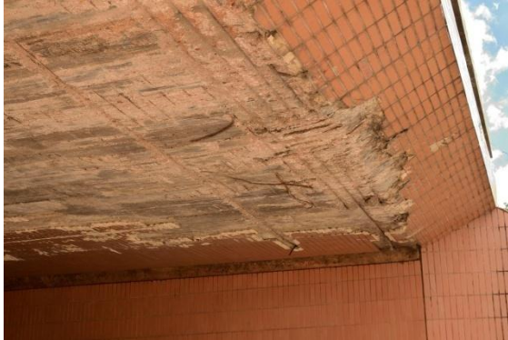
Tabuleiro do viaduto do eixo L entre as quadras 203/204 norte apresentando armadura metálica rompida.
