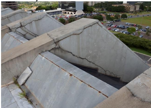
Rachaduras nas vigas estruturais do Teatro Nacional.
