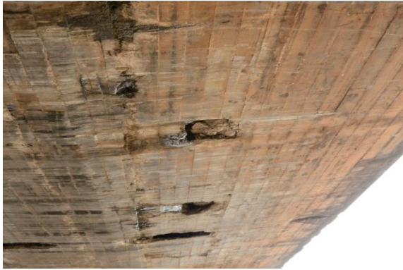
Parte inferior do tabuleiro da Ponte do Braguetto danificada apresentando múltiplas infiltrações e armadura metálica exposta, apresentando sinais de corrosão.
