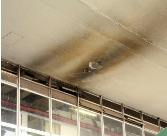
Esquadrias e alvenaria danificadas.
