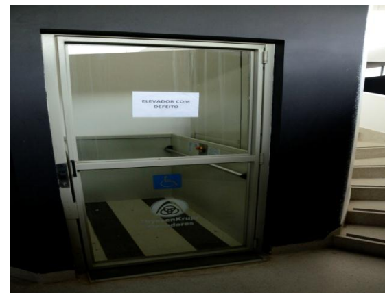
Elevador com defeito, sem contrato de manutenção.
