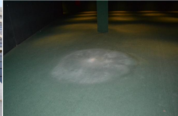
Mofo no carpete da Sala Villa-Lobos.
