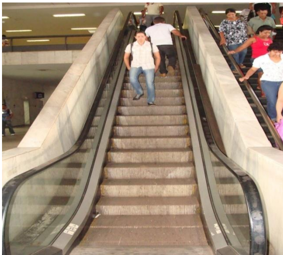
Escada rolante da rodoviária inoperante.
