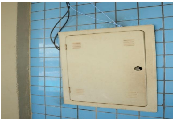
Quadro elétrico com fios aparentes.
