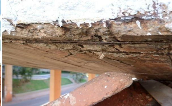
Armadura metálica aparente no viaduto do eixo W sobre a N2 apresentando sinais de corrosão.
