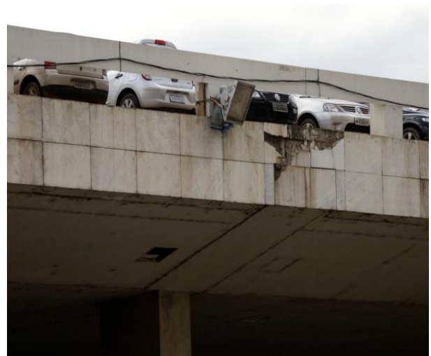
Desprendimento de revestimentos na plataforma superior da rodoviária.
