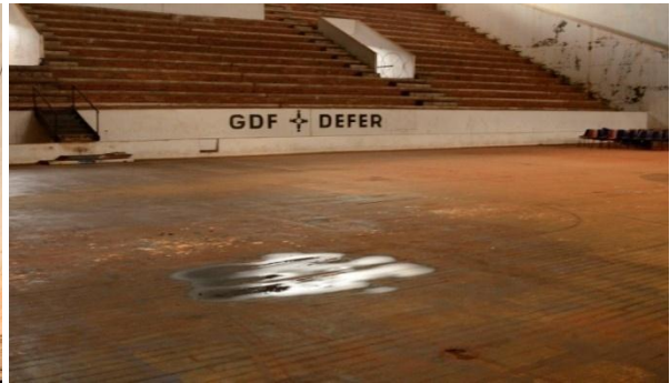
Área interna degradada por falta de manutenção.
