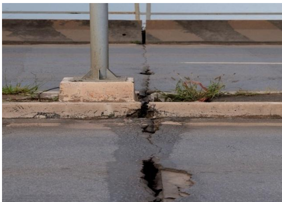
Junta de dilatação danificada na Ponte das Garças.
