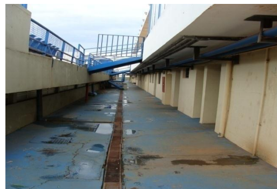
Grelhas de drenagem mal posicionadas.
