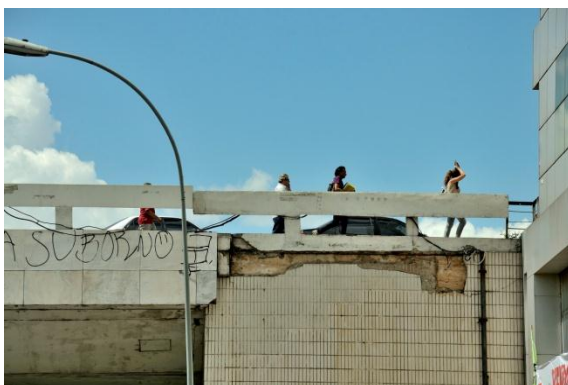
Desprendimento de revestimentos, sinais de infiltração e guarda-corpo desalinhado, ao lado do CONIC.
