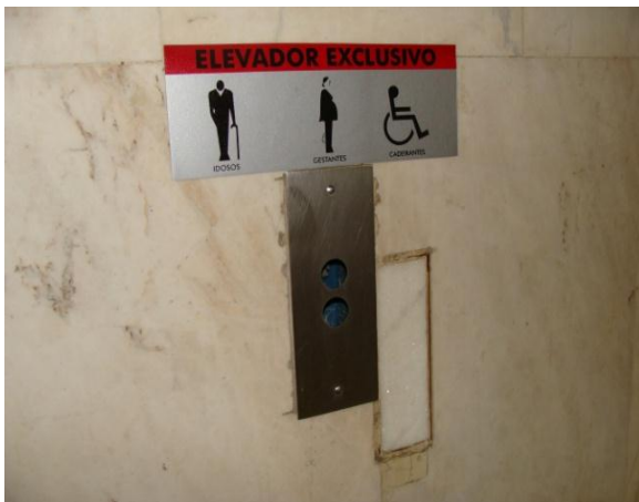
Elevadores da rodoviária inoperantes.
