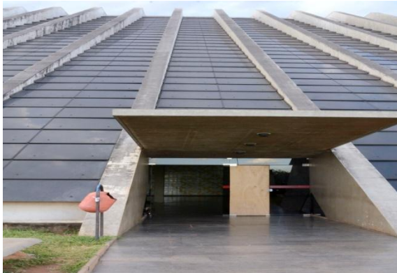
Porta da Sala Martins Penna quebrada.
