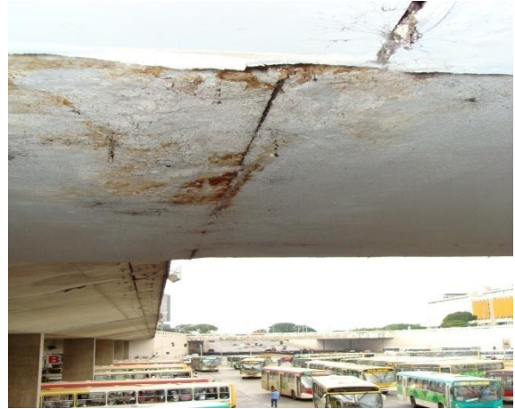
Infiltração com sinal de desagregação do concreto e carbonatação na plataforma superior da rodoviária.
