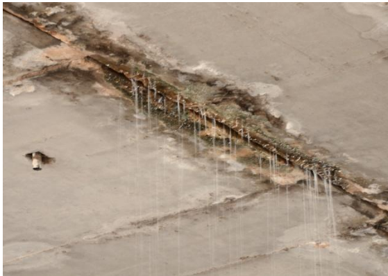
Infiltração nas juntas de dilatação do viaduto da plataforma superior da rodoviária.
