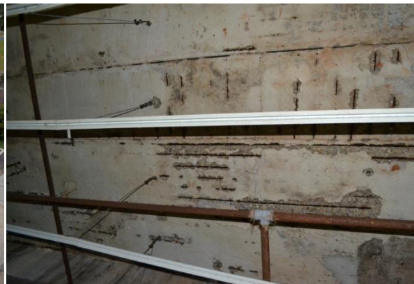
Face interna da parede externa apresentando sinais de infiltração e armadura metálica exposta.
