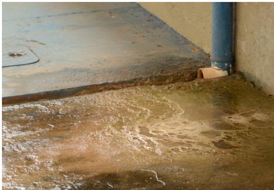
Carbonatação decorrente de infiltração da piscina.
