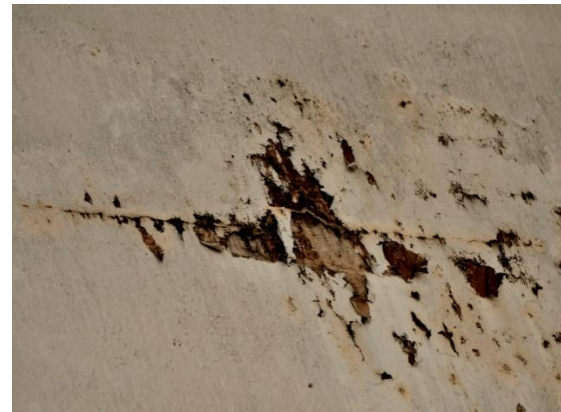
Desagregação do concreto na face externa do Museu.
