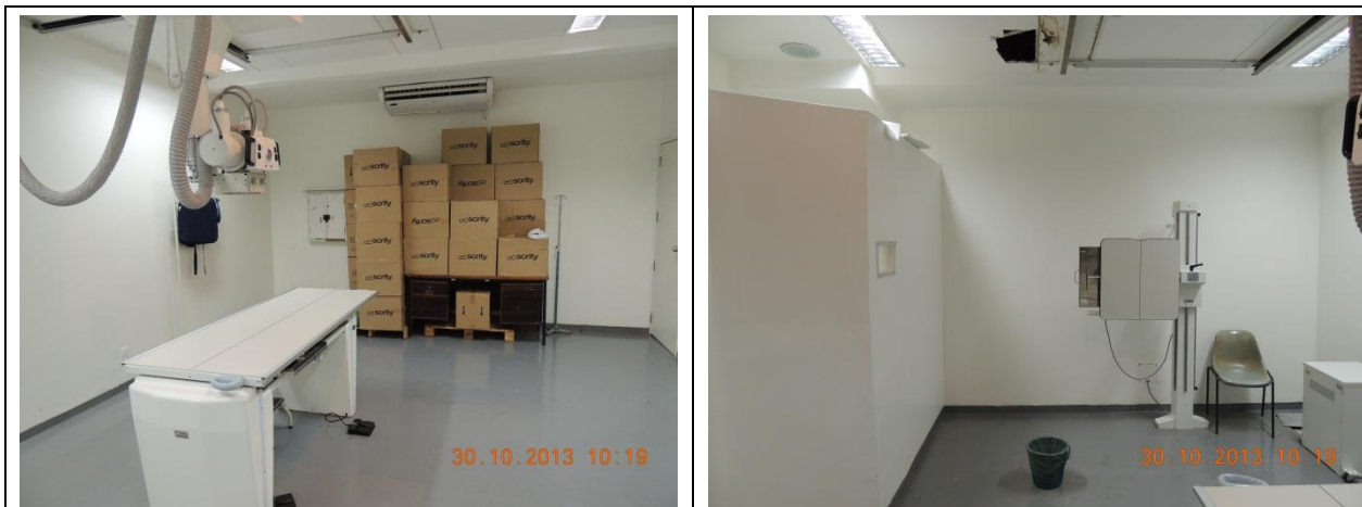
Foto 31 e 32: Hospital Regional do Guar – material inapropriado e vazamento na sala do RX fixo
