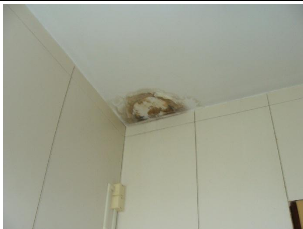
Foto 27: Central Radiológica de Taguatinga – infiltração
