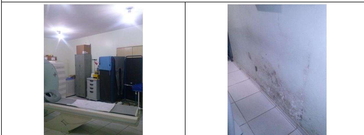
Foto 33 e 34: Hospital Regional de Ceilndia – material inapropriado junto ao tomgrafo e infiltrao na sala do RX fixo
