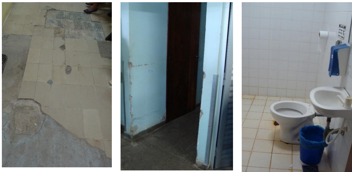
Figura 3 Estado de conservação precário dos ambientes do serviço de diálise no HRS. (Visita em 30/03/15)
