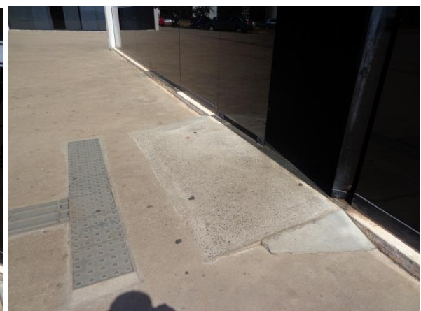
Rampa com defeito.
