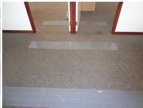
Descontinuidade de acessibilidade.
