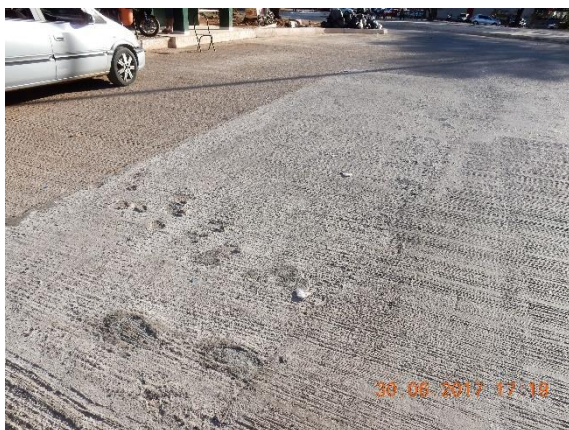
Marcas de pegadas no pavimento rígido de Planaltina.
