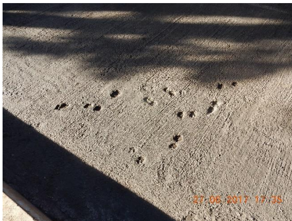
Marcas de pegadas no pavimento rígido de Taguatinga Sul.
