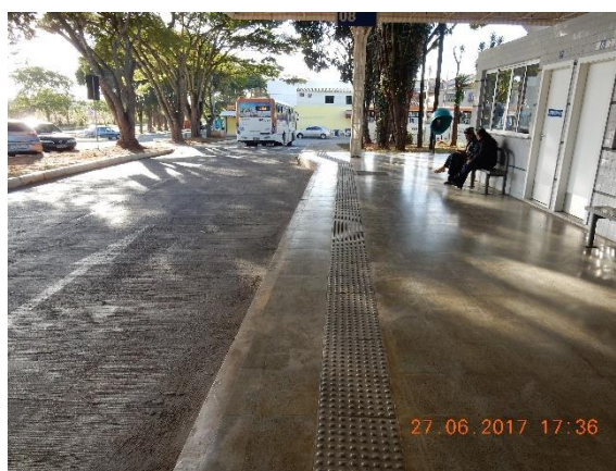
Falta de contraste entre o piso tátil e o piso adjacente – Taguatinga Sul.
