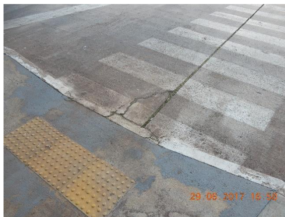
Quebra de canto no pavimento rígido de Taguatinga M Norte.
