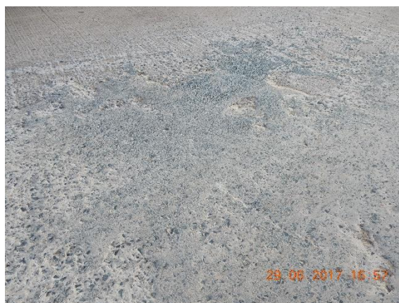
Descamação e agregado exposto no pavimento rígido de Taguatinga M Norte.
