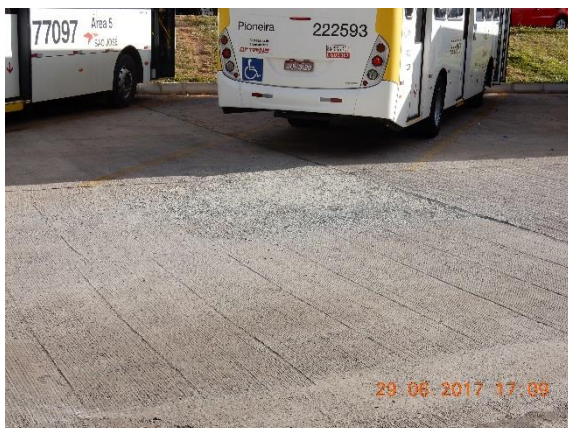
Descamação e agregado exposto no pavimento rígido de Taguatinga M Norte.
