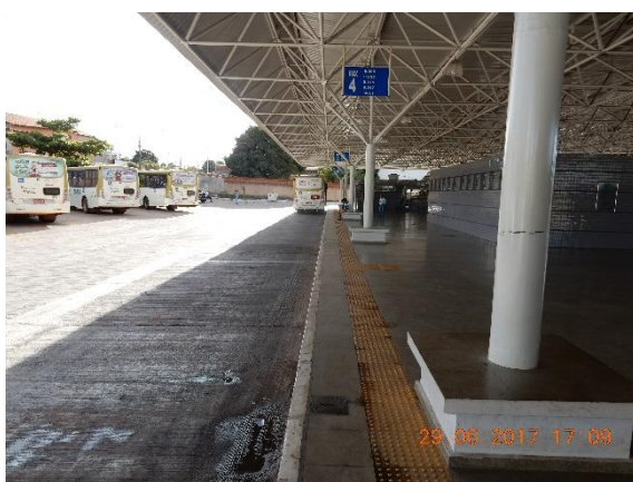
Falta de piso direcional indicando todo o caminho até os ônibus – Taguatinga M Norte.
