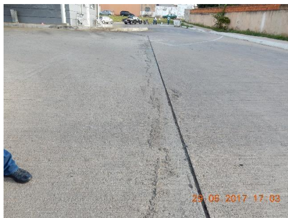
Excesso de material no pavimento rígido de Taguatinga M Norte.
