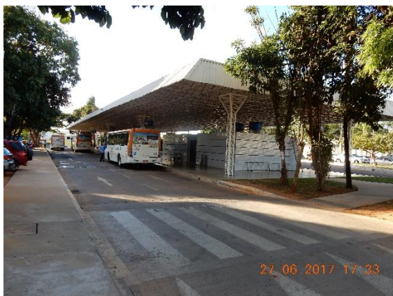
Falta de piso de alerta na transição entre calçada e pista – Taguatinga Sul.
