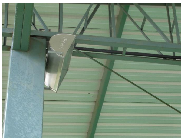
Figura 17 – Refletores sem estrutura elétrica para ligação
