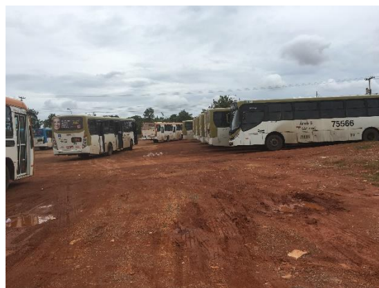
Figura 14: "Pavimento" do Terminal da Asa Norte
