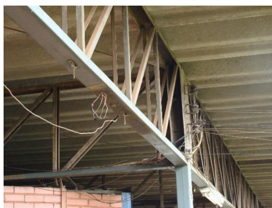
Figura 10 - Fiação exposta no Terminal de Sobradinho Centro
