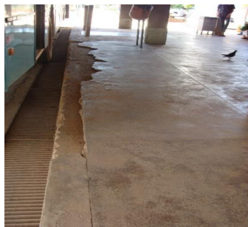
Figura 16: Meio-fio da Rodoviária de Brazlândia
