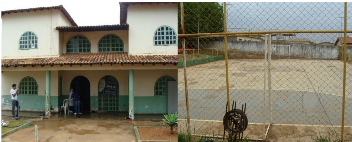
Imagem 4. APAE Guará Estrutura física necessitando de reforma e adequações (Prédio não utilizado por promover risco aos usuários e quadra poliesportiva)
