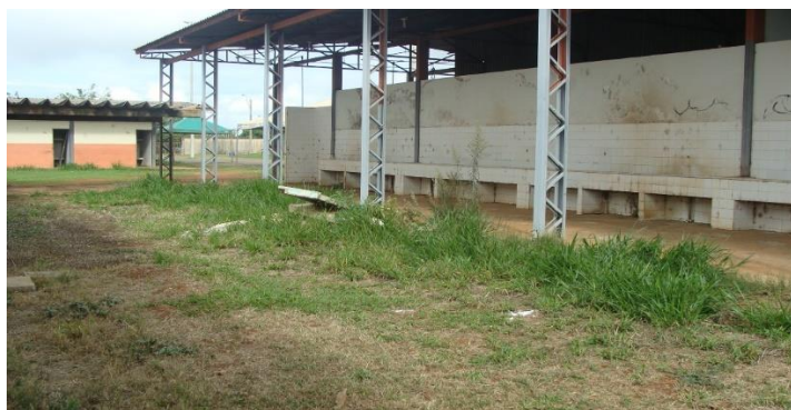
Imagem 15. UNAF – Banheiro desativado
