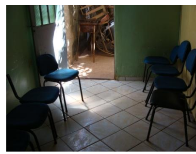
Foto 25: UBS Vila Estrutural – ambiente sem claridade
