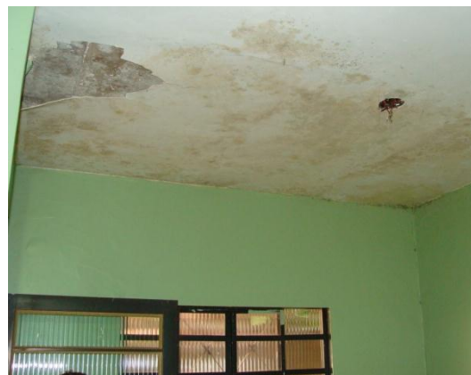
Foto 22: UBS Vila Estrutural – teto mofado
