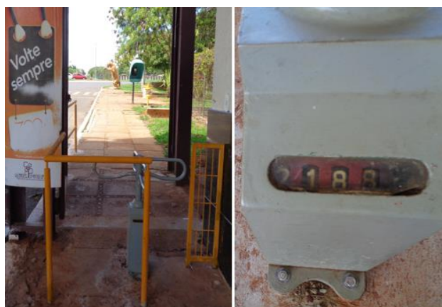
Figura 6 - Catraca instalada na saída de pedestres
