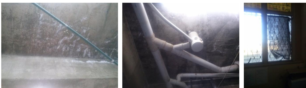
Figura 3: Hospital Regional de Ceilândia – teto sem forro, encanamento sobre o estoque e janelas sem proteção contra incidência solar.
