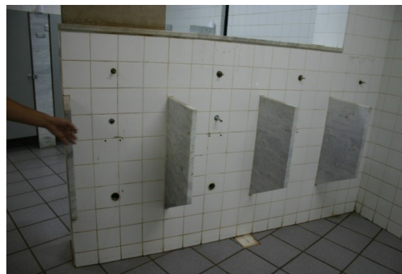
Mictório destruído em banheiro - Terminal Asa Sul
