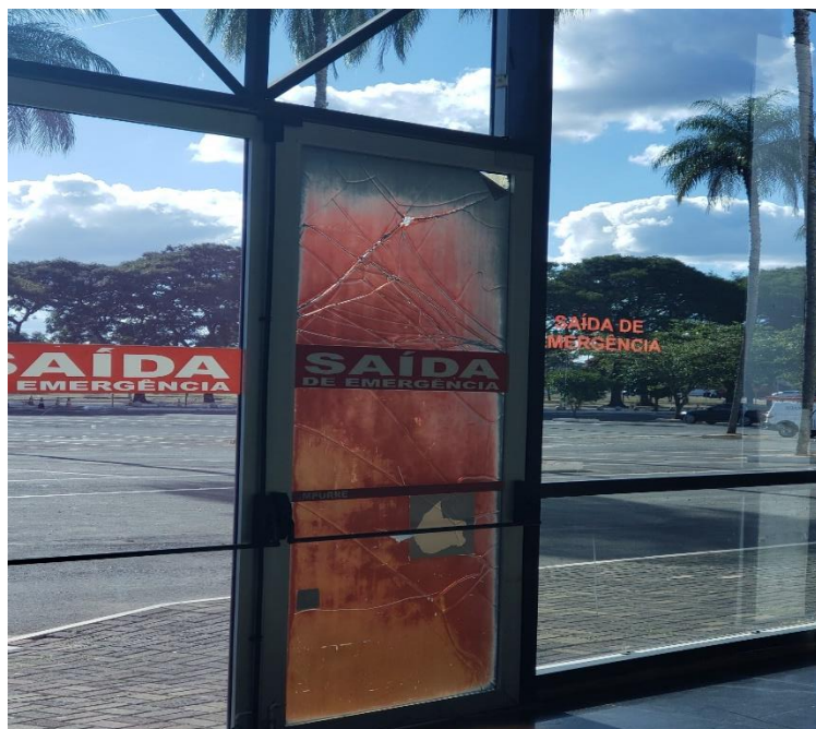
Figura 2 – Vidro trincado da fachada posterior da Ala Oeste
