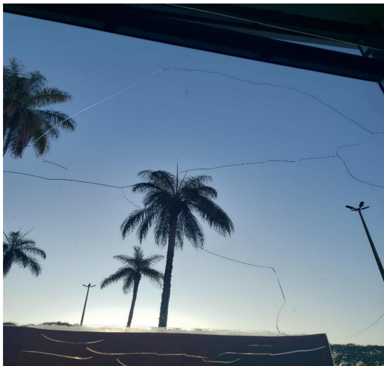
Figura 1 – Vidro trincado da fachada da Ala Sul
