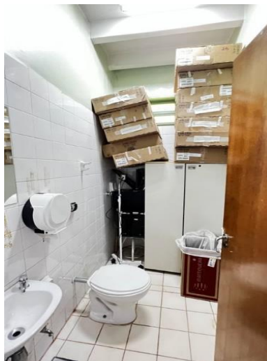
UBS 14 – Ceilândia – caixas e mobiliários armazenados no banheiro
