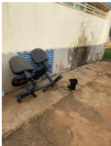
UBS 02 – Riacho Fundo II – Mobiliário entulhado
