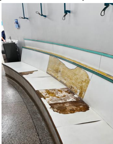
UBS 02 – Águas Claras – Banco quebrado (superfície danificada) em local de espera da unidade
