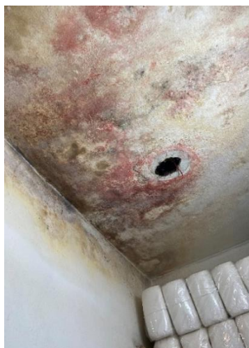
UBS 12 – São Sebastião - Teto com mofo
