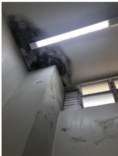
UBS 01 – Riacho Fundo - Teto com mofo na sala de inalação
