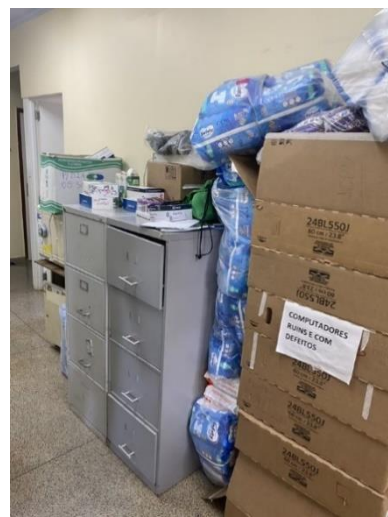
UBS 8 – Santa Maria – caixas de materiais, fraldas, documentos e equipamentos armazenadas no corredor de acesso aos consultórios
